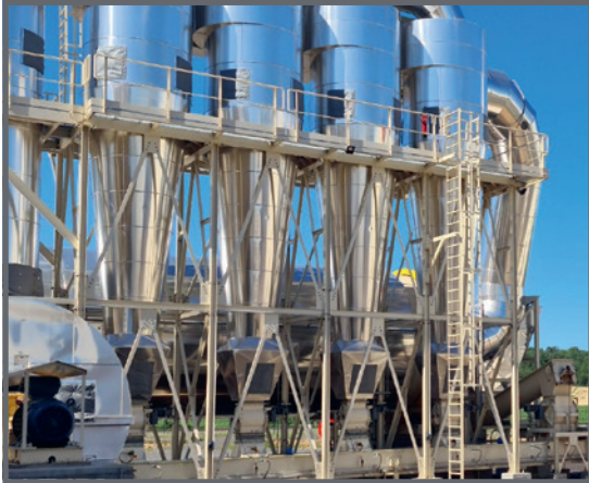
Trasmec verfügt über jahrzehntelange Erfahrung mit maßgeschneiderten Anlagen für die Holzwerkstoffindustrie
